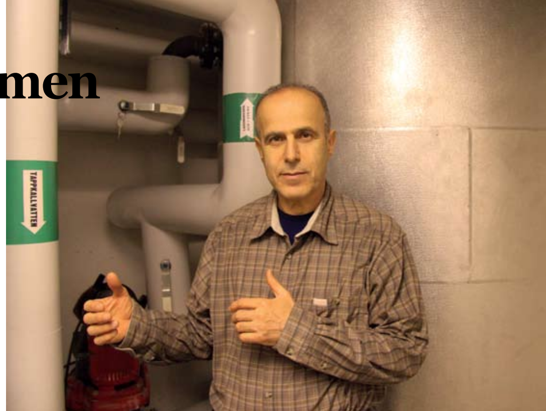
Kazem Zyabari framför den stora vattentanken i undercentralen på Östervägen 6 i Kungsängen. Foto: Lena Malmsten-Bäverstam, Ordblick
